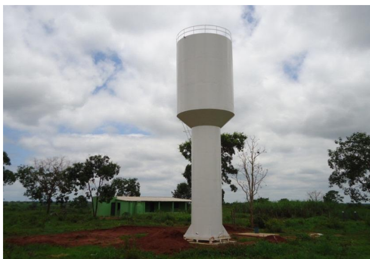
Figura 2: Perfuração do poço e instalação de reservatório de 30 mil litros. Assentamento 20 de Março, Três Lagoas/MS
